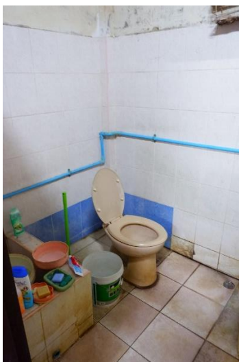
ภาพที่ ๘ ห้องน้ำของบ้านหลังที่ ๑ โถส้วมไม่มีที่พึ่งหลัง ไม่มีราวจับ ไม่มีฝักบัวอาบน้ำติดตั้งให้คนพิการใช้งานได้
